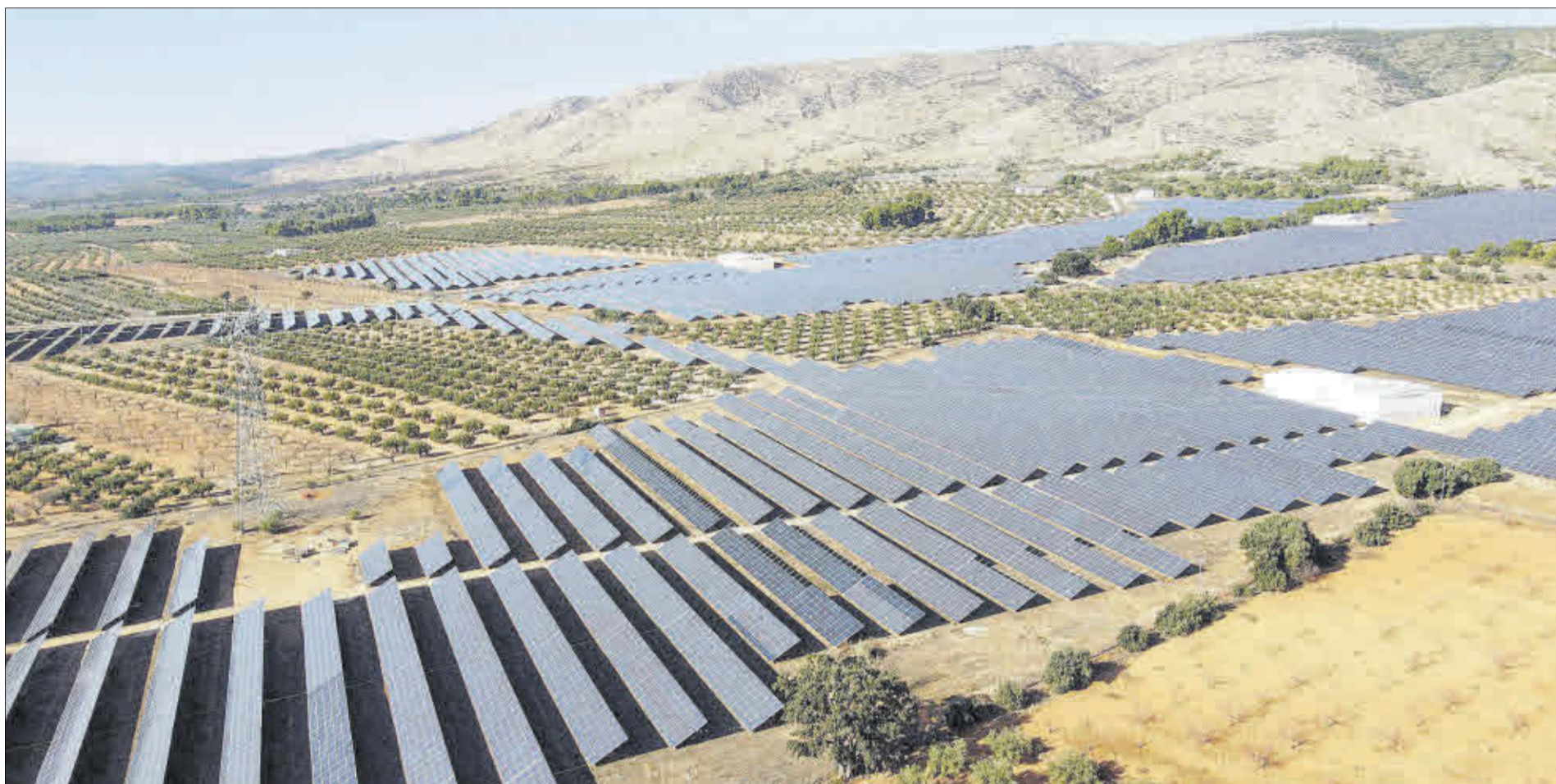
Todas las centrales solares fotovoltaicas proyectadas en el Alto Vinalopó contemplan evacuar la energía que generen en la subestación eléctrica de Beneixama.
